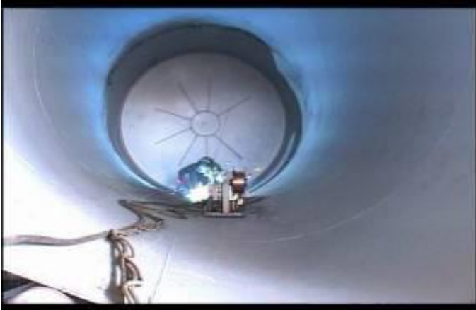
Tanque vertical de 1000 m 3
